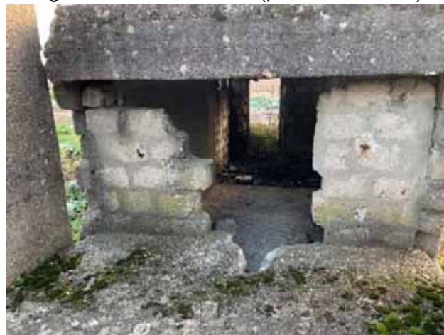
Fig. 45 : Local du compresseur (photo JP Rolley)
