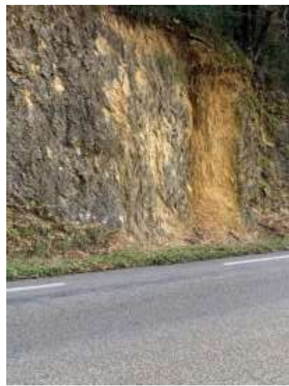
Fig.10 : Santonien ? vertical et complètement écrasé (Photo JPR)
